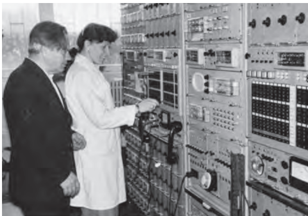
Проверка работы оборудования ЛАЦ
